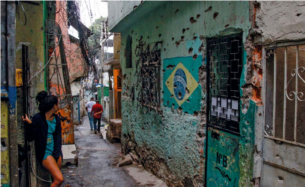
Wie im Krieg: Wand eines Wohnhauses in Rio de Janeiro mit zahlreichen Schusslöchern
